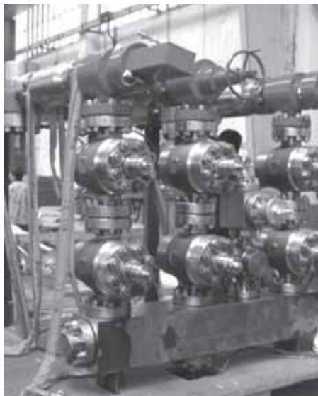
De 12 ton wegende 15K choke manifold tijdelijk geïnstalleerd op de boorvloer. (Foto: Noble Drilling)
